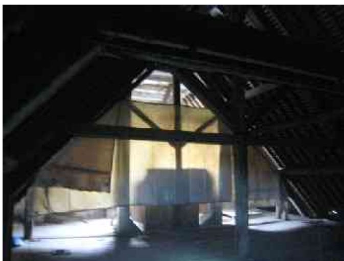
A Hermes (60) Assombrissement du comble
