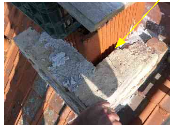
Secteur d'Amiens (80) Interstice créé dans la maçonnerie
